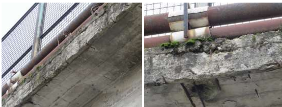
Figura 6.6 – Ammaloramenti velette laterali
